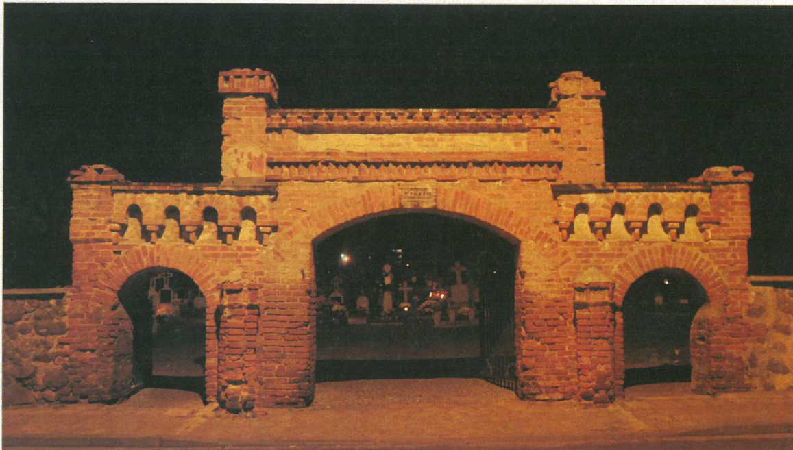
Zabytkowa XIX-wieczna brama starego cmentarza wymaga gruntownego remontu
