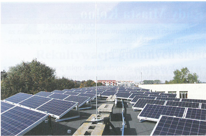
3. Szkoła Podstawowa nr 2 im. H. Sienkiewicza w Kolnie – instalacja o mocy 30kW
