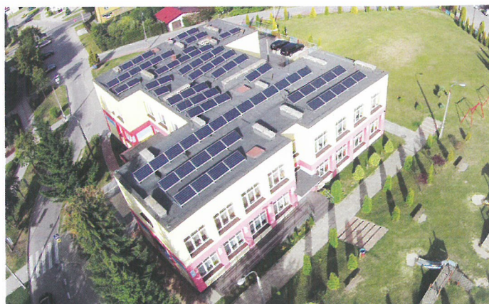
2. Przedszkole Miejskie nr 4 w Kolnie - instalacja o mocy 20kW
