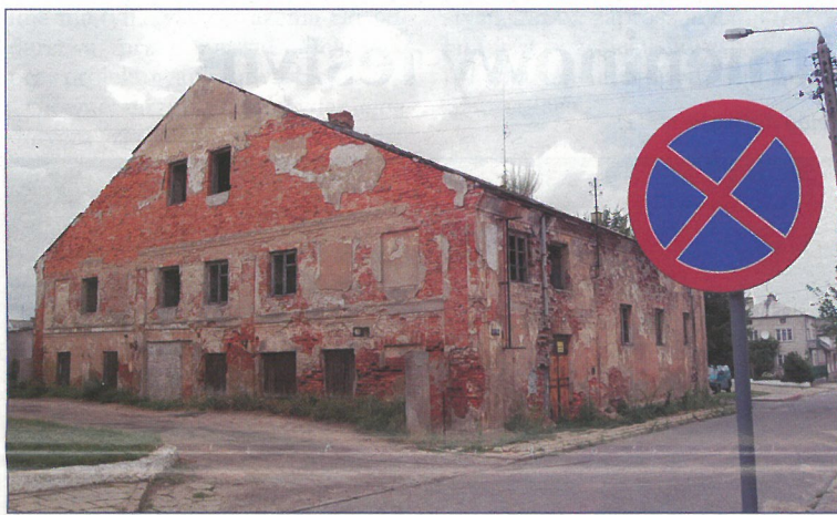
■ obecny stan bożnicy jest problemem, budynek szpeci swoim wyglądem od lat.
